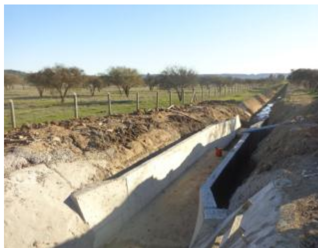
Caída vertical, Km 11.200.
