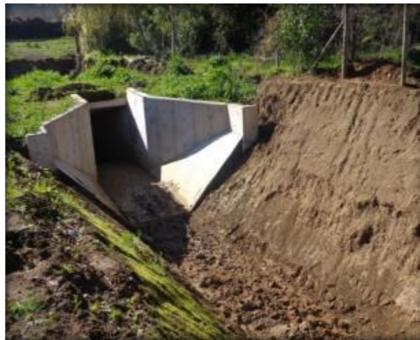
Cámara de salida de Sifón Fortaleza.
